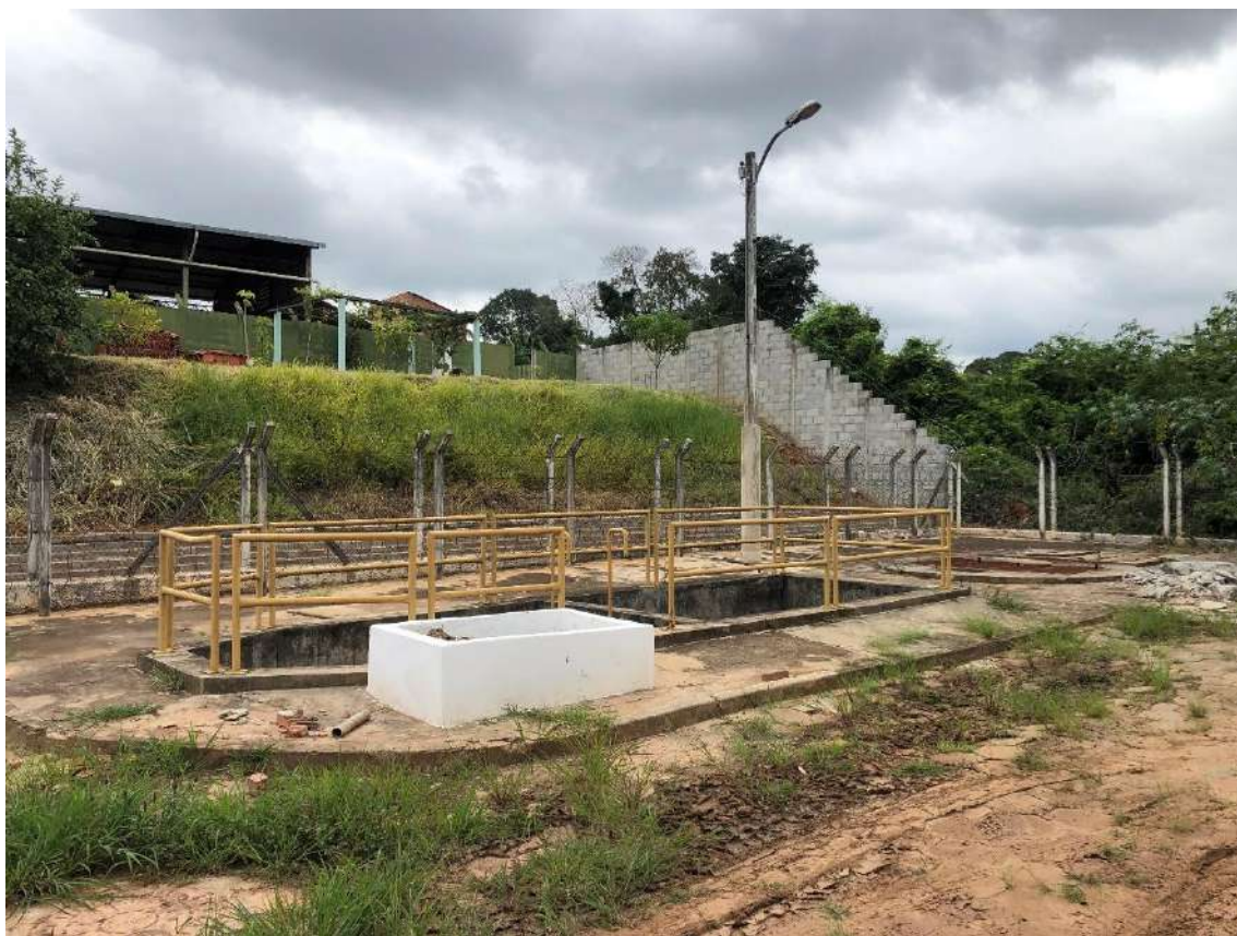
Figura 36 - Detalhe da EEE 3 do SES Sede
