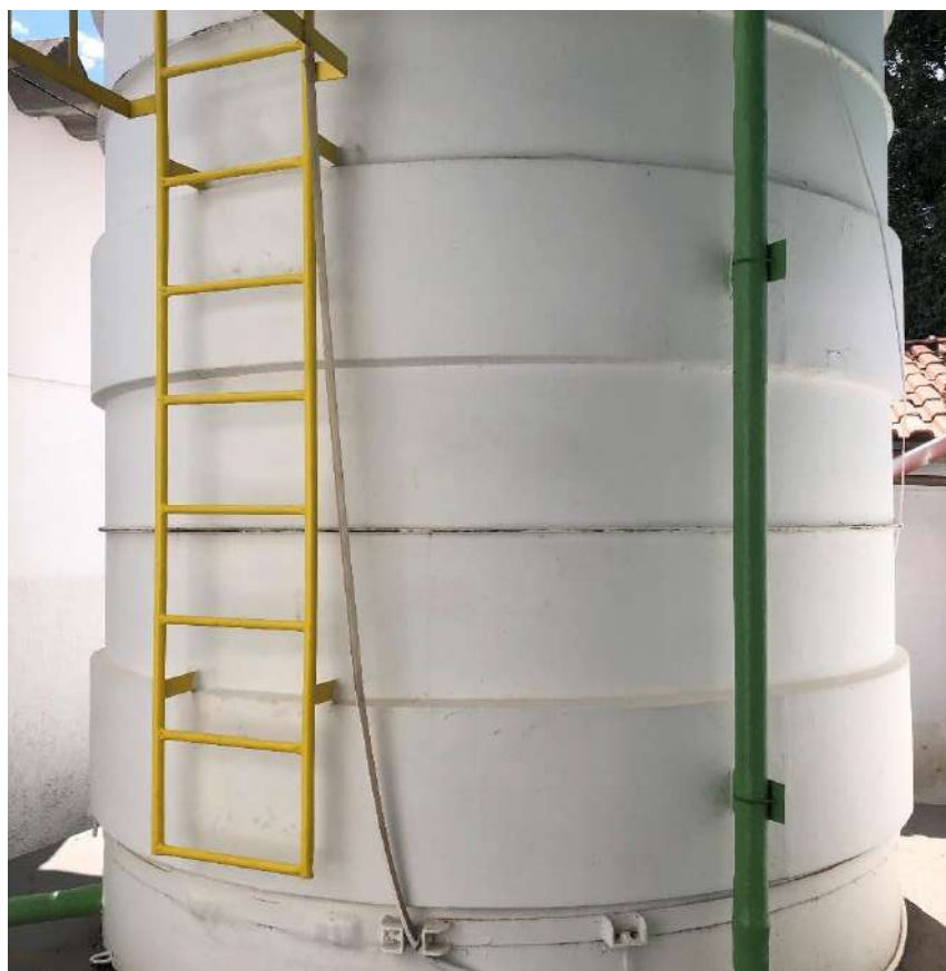
Figura 32 - Detalhe do reservatório 01 do Distrito de Laras
