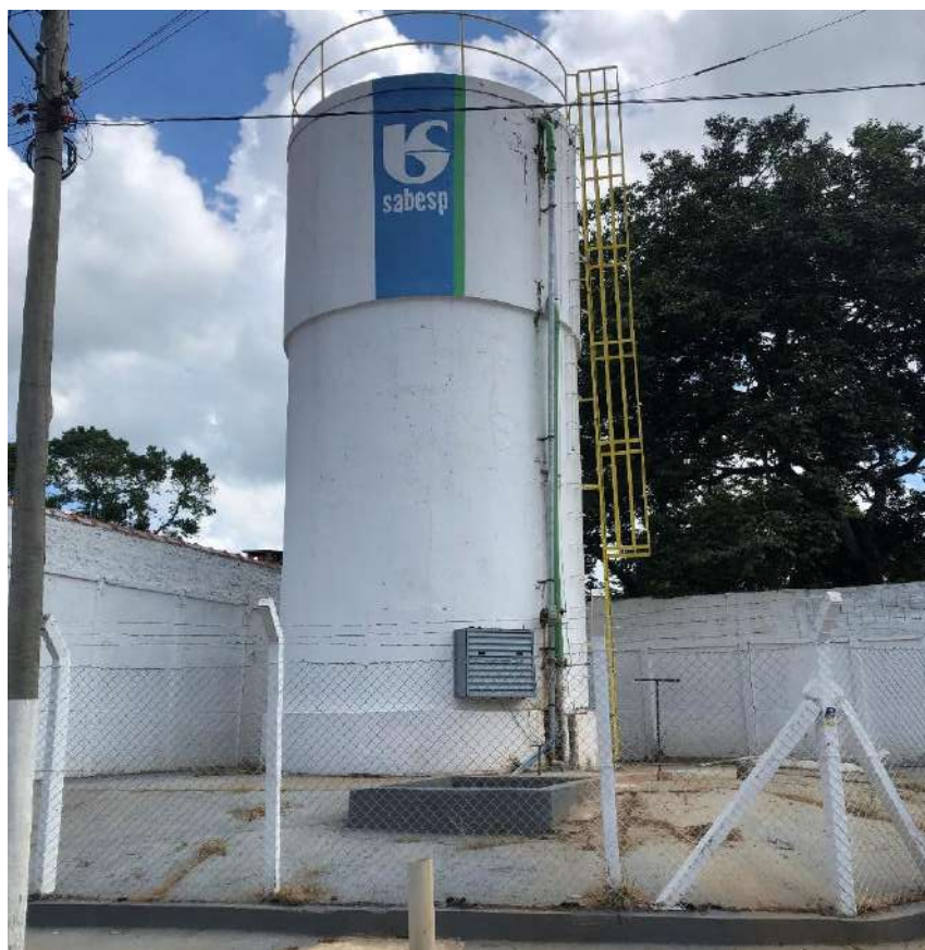
Figura 33 - Detalhe do reservatório 02 do Distrito de Laras
