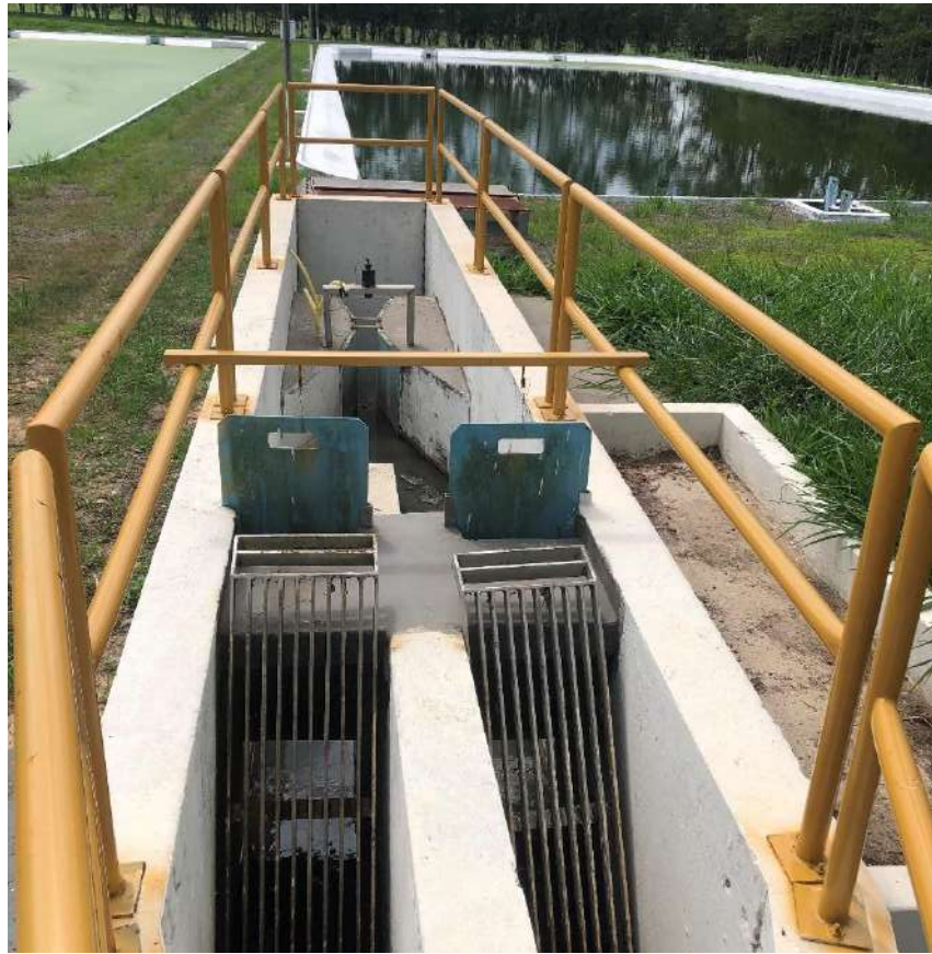
Figura 41 - Detalhe da ETE Laras do SES Laras
