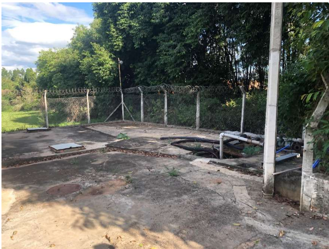
Figura 37 - Detalhe da EEE Recanto Laranjal do SES Sede
