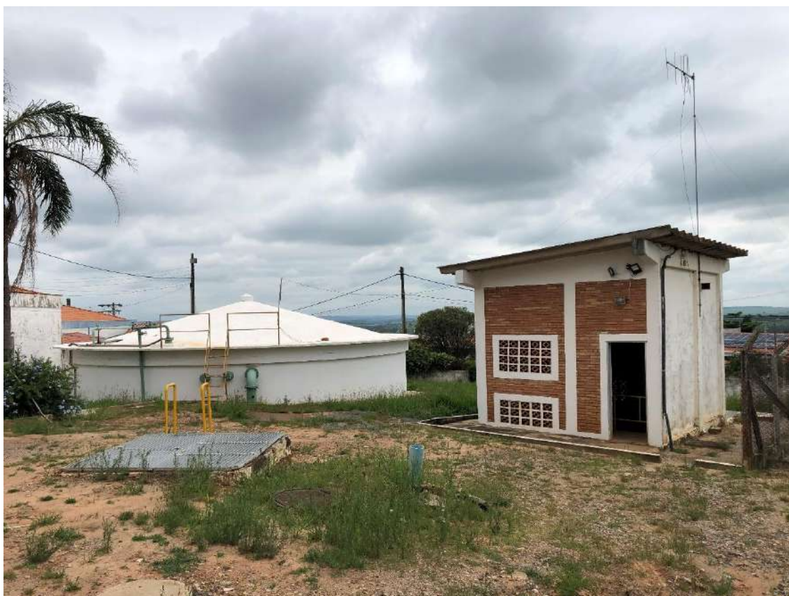
Figura 23 - Detalhe do Reservatório 01 (ETA) na sede do município
