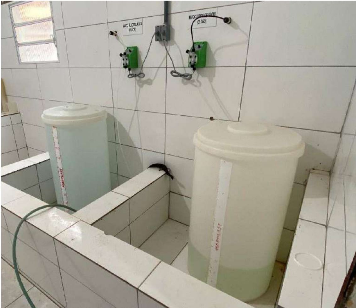
Figura 16 - Dosagem de cloro e flúor – ETA Laras (Tratamento Simplificado). Fonte: PMSB
