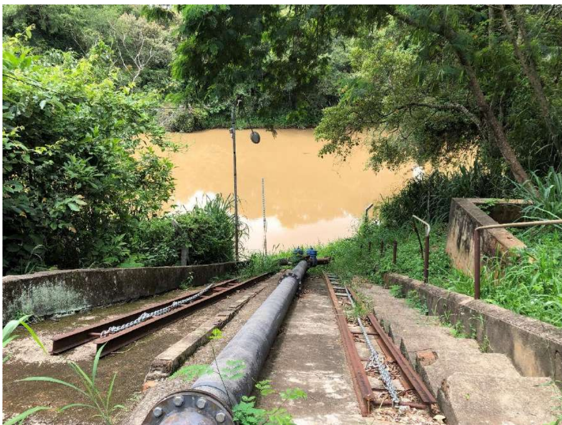
Figura 9 - Captação de água bruta rio Sorocaba (EEAB 01)
