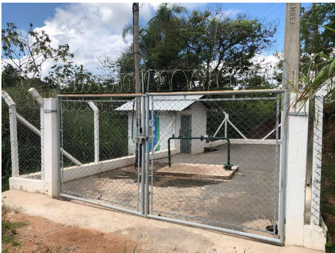
Figura 12 - Detalhe do Poço P2 do Distrito de Laras
