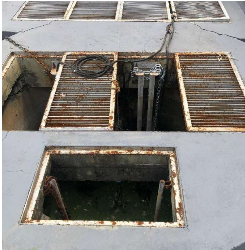
Figura 39 - Detalhe da EEET (ETE Laras) do SES Laras
