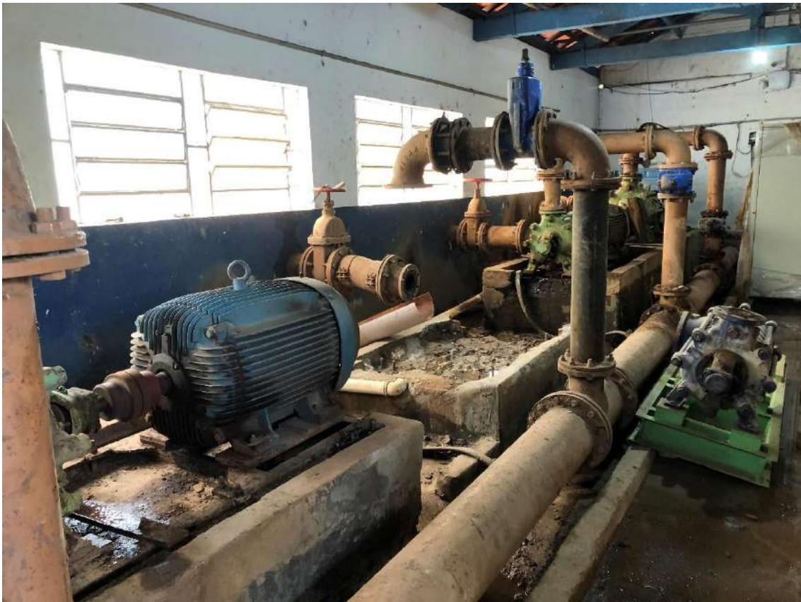
Figura 10 - Elevatória de água bruta EEAB 02.
