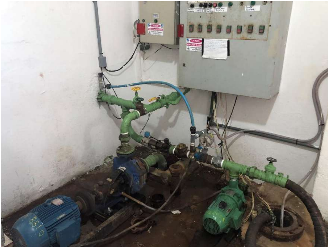
Figura 19 - Detalhe EEAT 01 e 02 (Laras) – abastecem os reservatórios 02, 03 e 04
