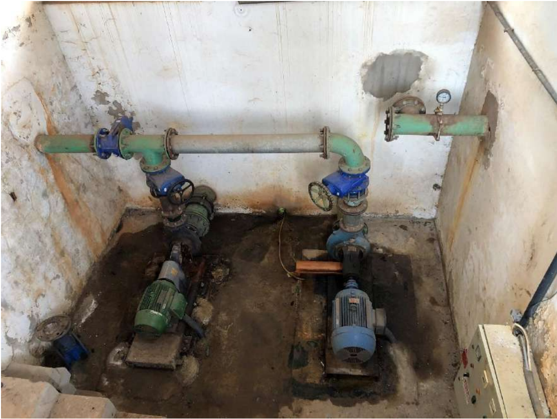
Figura 17 - Detalhe EEAT (ETA) – abastece o Reservatório 01 (ETA) de 1000m 3 na sede
