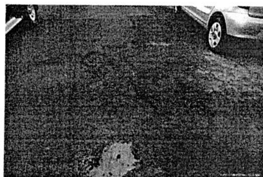
Foto 22. Rua Caetano Baffa detalhe pavimento danificado
